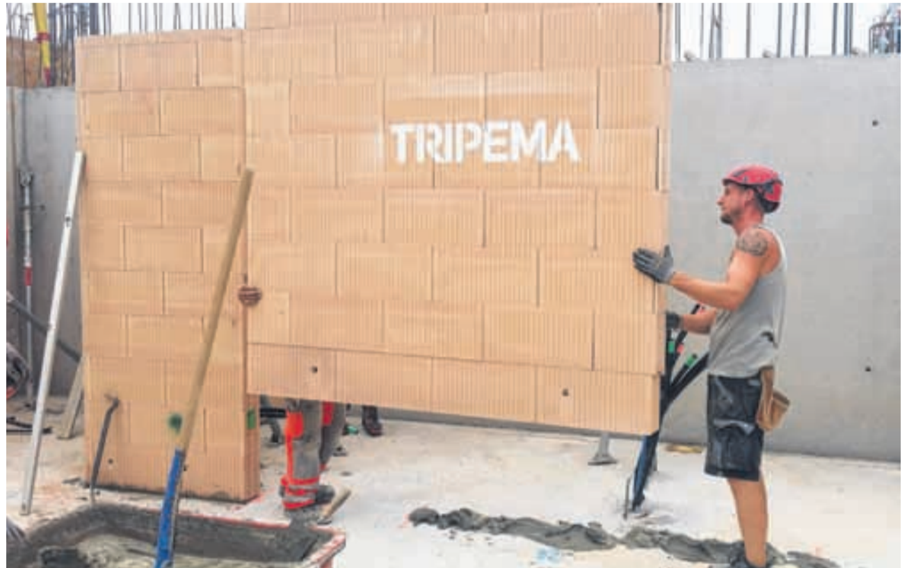
Die Fertigelemente werden von zwei Arbeitern auf einer Baustelle in ein Mörtelbett und Unterlagsplättchen eingesetzt.
